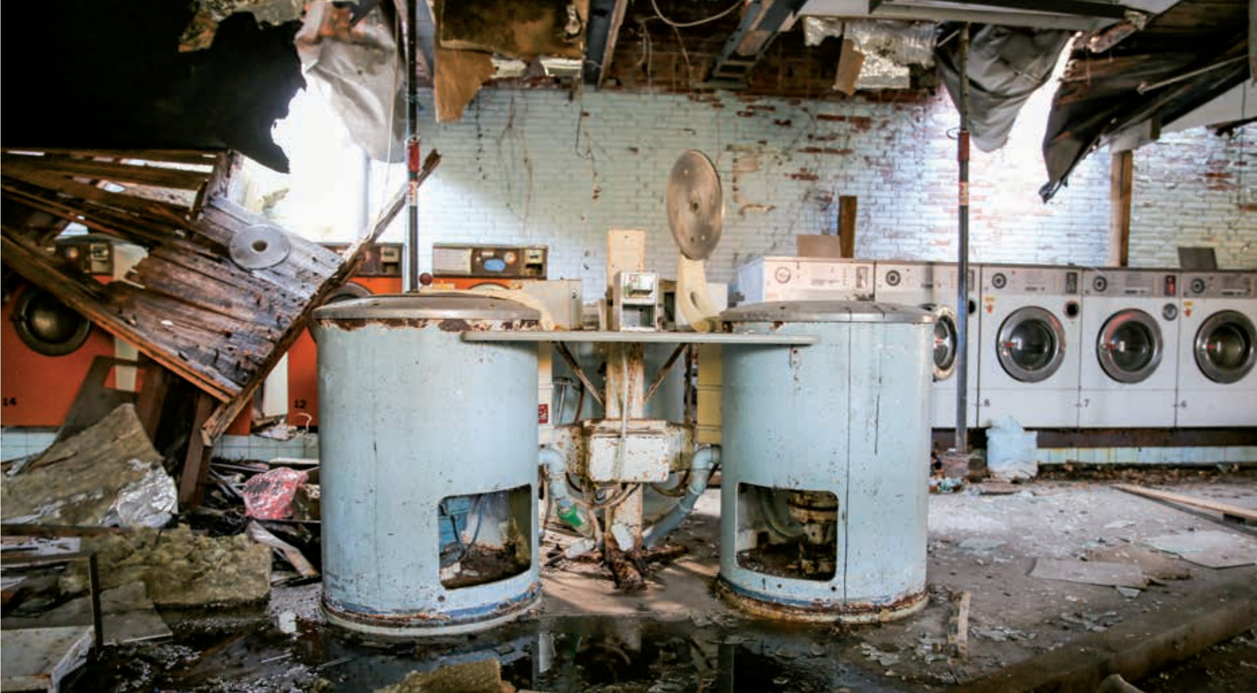
Taget er kollapse et over en del af bygningen. Foto: Tim Panduro
